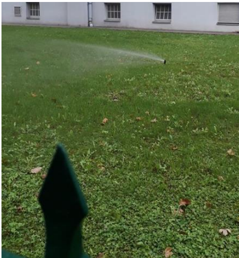
Abbildung 1: Sprenkieranlage in Betrieb, 03.09.2018, 07:51
