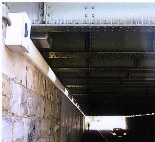
Bild 2 (Quelle ÖBB INFRA AG)
